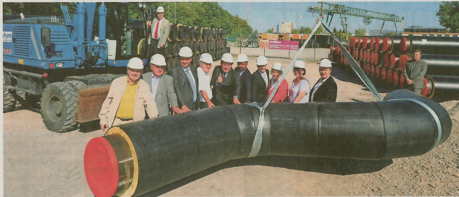
Im Sommer 2011 begannen die Bauarbeiten für eine neue Fernwärmehauptleitung im Süden von Karlsruhe. Sie erschließt zunächst Daxlanden, Grünwinkel und Oberreit. FOTO: DECK
